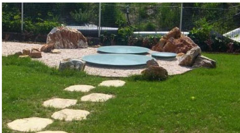
Obr. 11: Domáca čistiareň odpadových vôd
