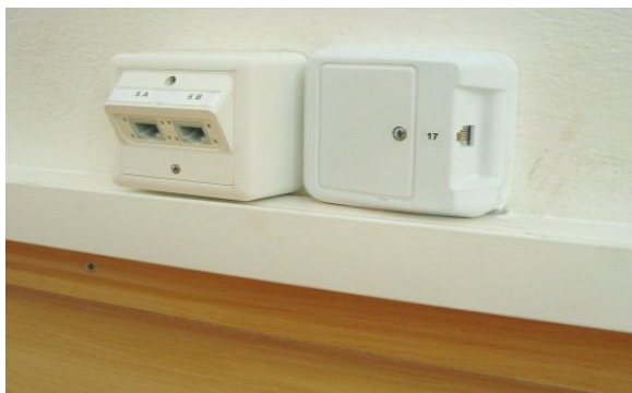
Kabeláž vedená v lište
