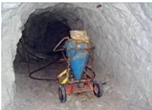
Obrázok 119: Tlakové nabíjacie zariadenie. Baníci donesú 25-kilogramové vrecia sypkej trhavy, nasypú ju do tejto súpravy a pod tlakom ju cez hadicu zafúkavajú do jednotlivých vývrto.
